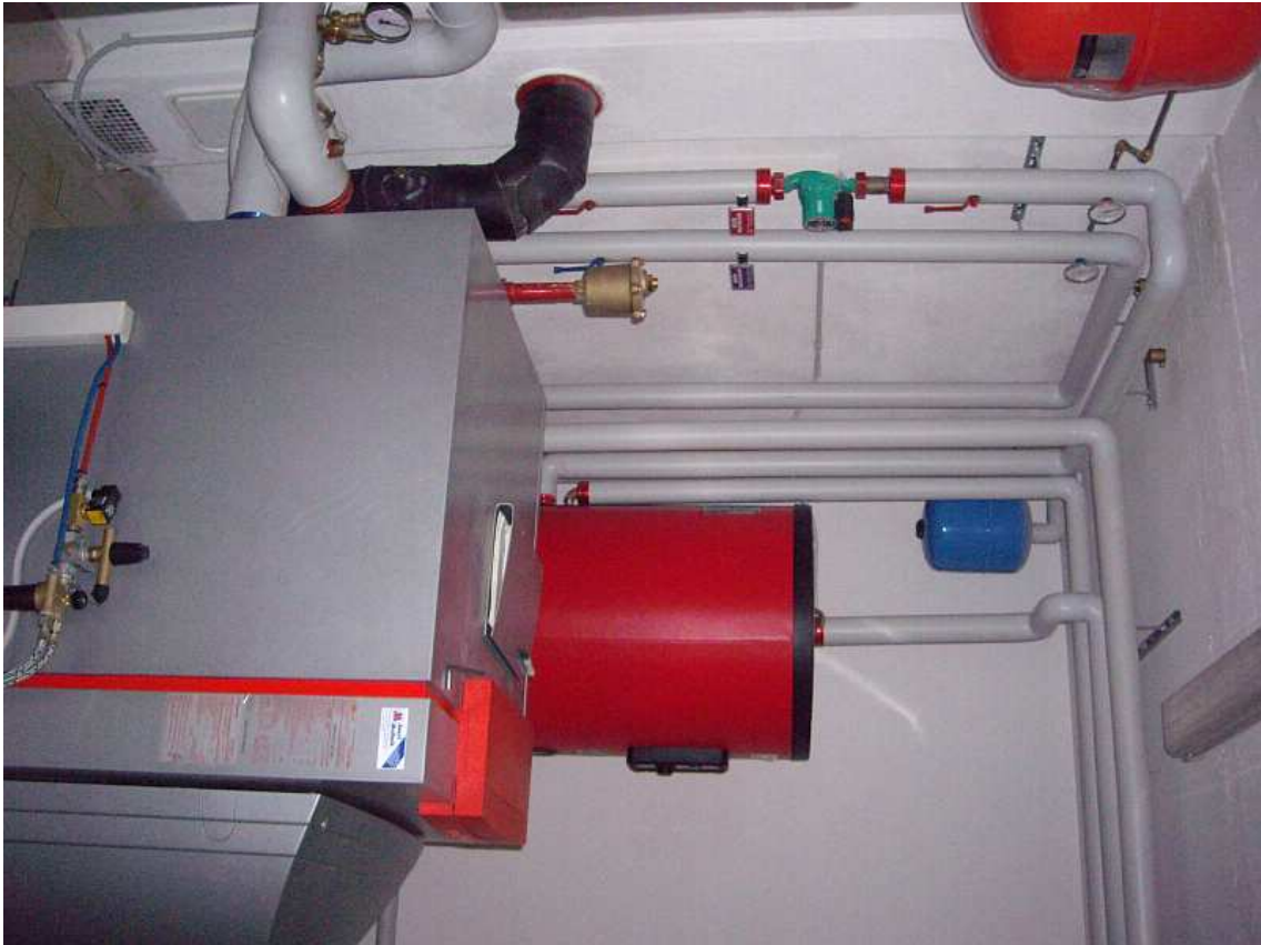
locale caldaia comune
