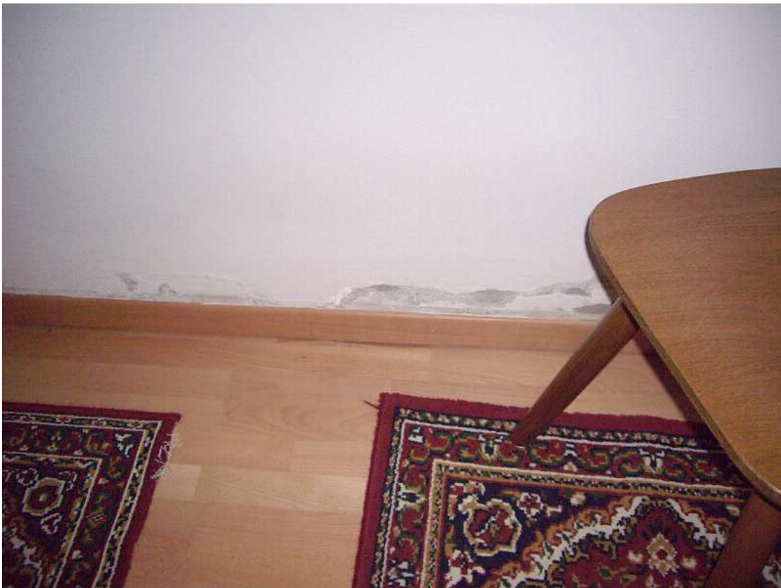
stanza con infiltrazioni d'acqua
