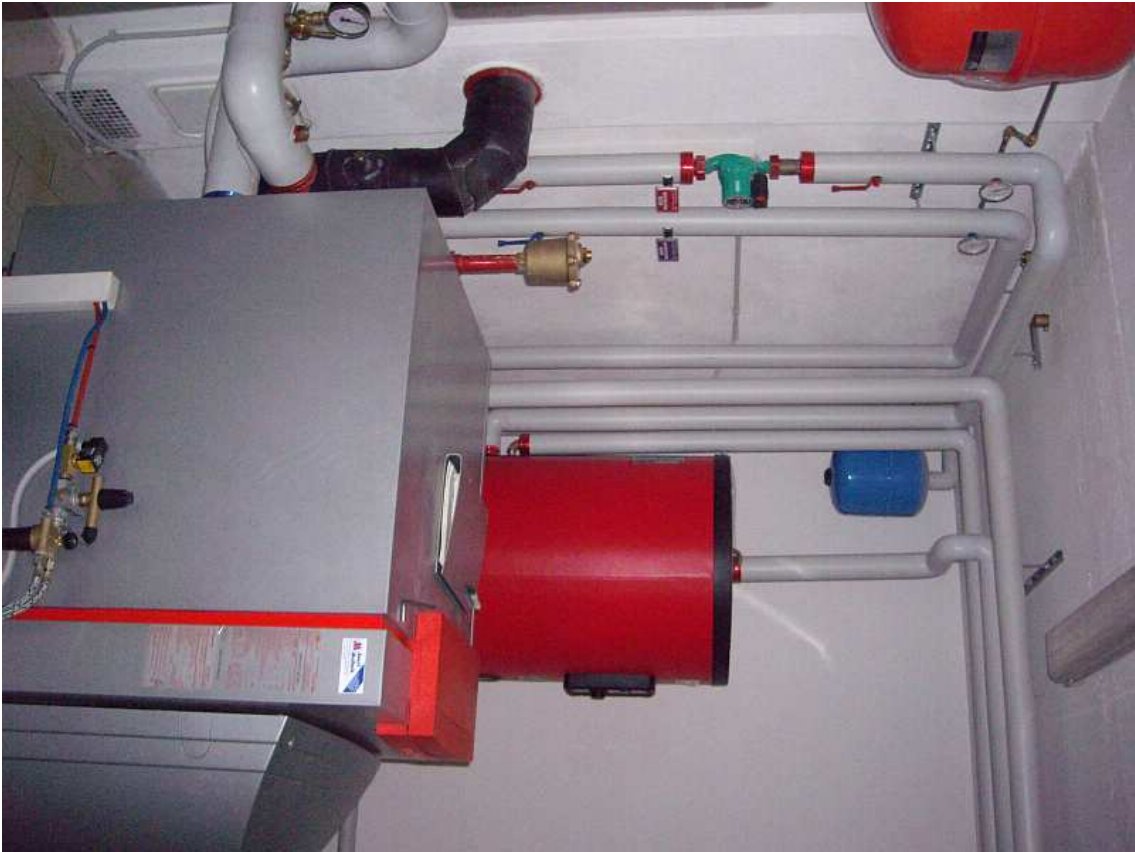
locale caldaia comune
